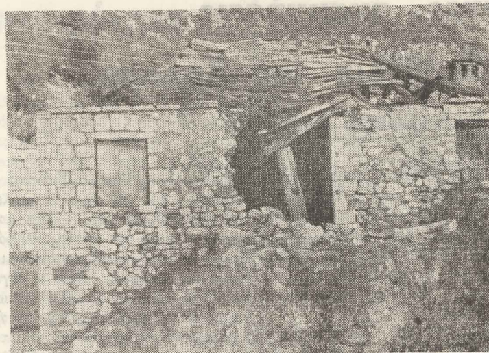
Το Αετοπετρίτικο Αμελικό πριν κατεδαφιστεί. Μεταπολεμικά είχε φιλοξενήσει το Σχολείο. Δυστυχώς όμως ο χρόνος και η παντελής έλλειψη συντήρησης το έφεραν από τον εικονιζόμενο χάλι. Δεν έμεινε τίποτε άλλο εκτός από την κατεδάφισή του η οποία και έγινε περίπου το 1979.
