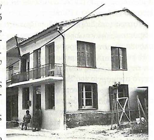
Σηκώνει το κτίριο που στεγάζετο το Ιατρείο Μαργαριτίου άλλες επισκευές; Μήπως πρέπει να προχωρήσουμε στο κτίσιμο νέου κτιρίου;
