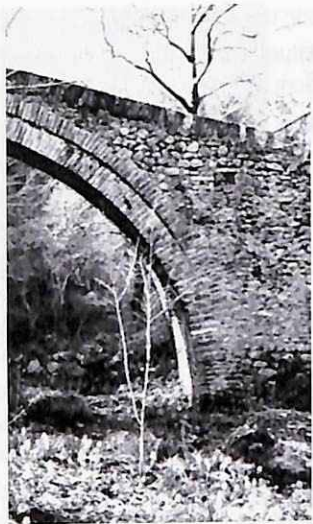
(Φωτ. 27-3) Δεξιό θάτρο «γέφυρας Πεκλαρίου Καραγιάννη». Όψη ανάντης. Λεπτομέρεια αρχής του ελλιπούς βοηθητικού τόξου. Στο τύμπανο ξεχωρίζει η εσοχή, μερικώς χτισμένη, που προοριζόταν για την επιγραφή/πλάκα.
