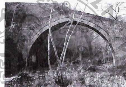
(Φωτ. 27-2) Ανάντης όψη της «γέφυρας Πεκλαρίου Καραγιάννη». Φαίνεται καθαρά το λείψο βοηθητικό στεφάνι του τόξου. Στη αριστερή όχθη μόλις που διακρίνεται η στήλη που φέρει την επιγραφή. [Πηγή: Παλιό εξώφυλλο στο περιοδικό "Κόνιτσα"].
