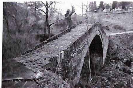
(Φωτ. 27-1) Η «γέφυρα Πεκλαρίου Καραγιάννη» πριν την επισκευή της το 1992 . Όψη ανάντης. Στο βάθος δεξιά διακρίνεται το νεκροταφείο του χωριού. [Πηγή: www.peklari.gr ].
