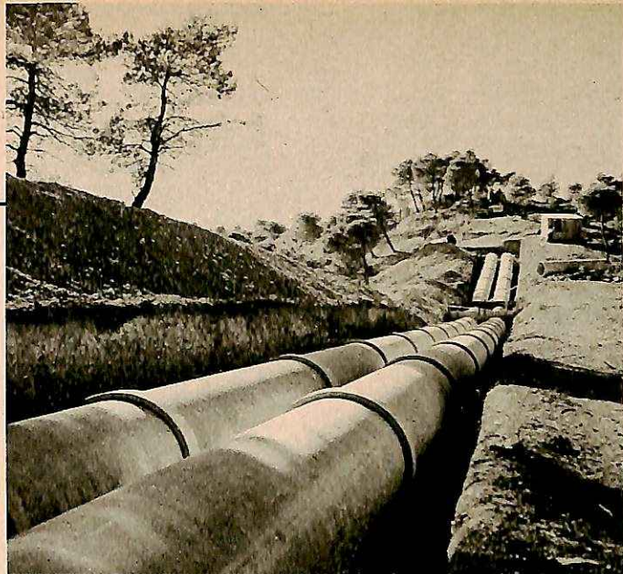
ΔΙΑΔΥΜΟΙ ἀγωγοὶ μεταφέρουν καθημερινὰ τεράστιες ποσότητες νεροῦ, ἀπὸ τὴ λίμνη τοῦ Μαρθαῶνα στὴν κατανάλωσι. "Ολόκληρο σχεδὸν τὸ λεκανοπέδιο τῆς 'Αθήνας τροφοδοτεῖται ἀπὸ τὴ λίμνη.
