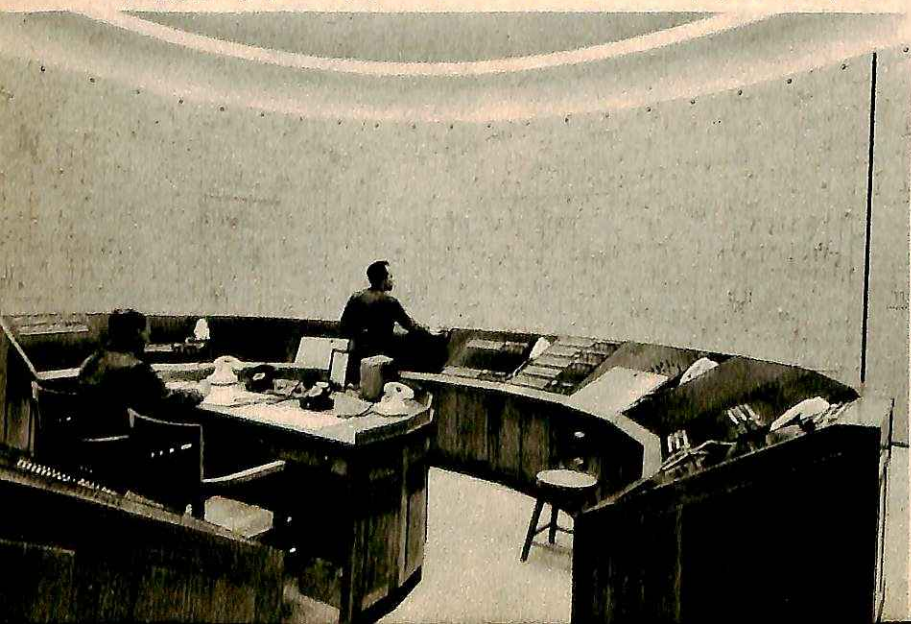
Ο ΣΤΑΘΜΟΣ ΕΛΕΓΧΟΥ καὶ διανομῆς ἡλεκτρικοῦ ρεύματος ἐπὶ τῆς ὁδοῦ 3ης Σεπτεμβρίου ἐκτελεῖ σπουδαιότατο ἔργο. Ὅπως λέγει καὶ ὁ τίτλος του, ἀπὸ τὸ σταθμὸ αὐτὸν ἐξαρτᾶται ἡ καλὴ διανομὴ καὶ ὁ ἐλεγχος πρὸς ὅλα τὰ σημεῖα τοῦ δικτύου. Στὸν τεράστιο αὐτὸν χάρτη μετὰ τὸ αὐτόματον ἀνάμμα τῶν πολυ- ἀριθμῶν ἡλεκτρικῶν λαμπτήρων, σημειώνεται ἡ καλὴ λειτουργία τοῦ ἀπερᾶντου δικτύου. Ὁ ἀρμόδιος μηχανικὸς πληροφορεῖται ἔτσι κάθε ἀνάγκη ποὺ προκύ- πτει στὴν περιοχὴ Ἀθηνῶν - Πειραιῶς καὶ κάθε βλάβη στὸ δίκτυο. Μετὰ τὸν τρόπο αὐτὸν εἶναι σὲ θέσιν νὰ ἐλέγχῃ ἀμέσως κάθε ἀδύνατο σημεῖο ἐκείστης περιοχῆς μετὰ τὴν μετακίνησιν ἀπλῶς καὶ μόνον ἐνὸς εἰδικοῦ πρὸς τοῦτο κουμπιῦ.
